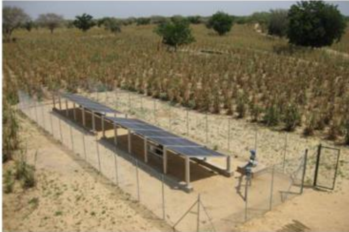
Champ de panneaux solaires clôturé
