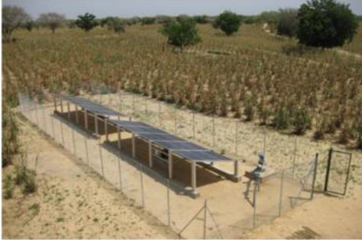
Champ de panneaux solaires clôturé
