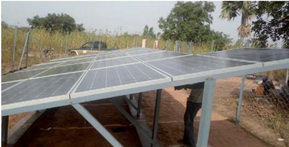
Vue d'un générateur photovoltaïque monté sur des supports fixe en acier galvanisé
