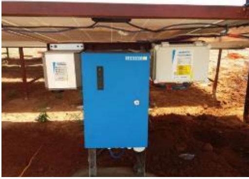
Présentation d'un contrôleur de pompe d'une station de pompage d'eau solaire
